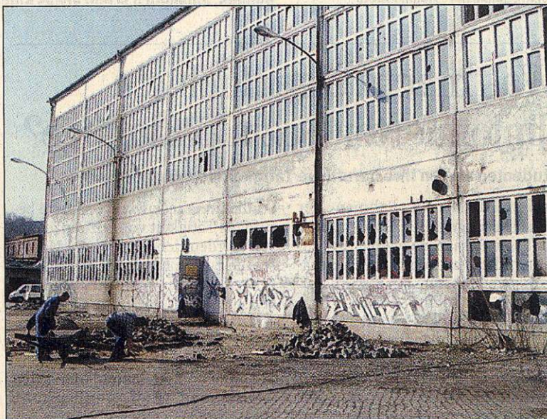
Dieses Gebäude stammt aus den Zeiten des VEB Technische Gase Schwarzenberg und hat in den letzten Jahren mächtig gelitten. –FOTO: WOLFGANG FREUND
